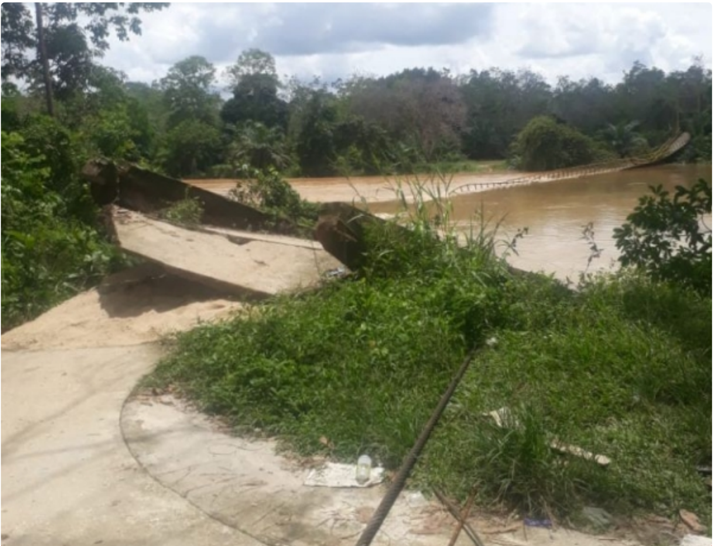
Jembatan Penyebrangan Ambruk
